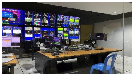
フィリピン: 国営放送局のマスターコントロールルーム
